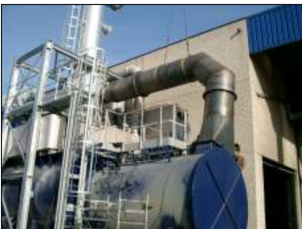
Stoom-recuperatieketel na de verbrandingskamer.
