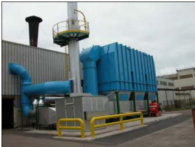
Regeneratieve Thermische Oxidizer (RTO).
