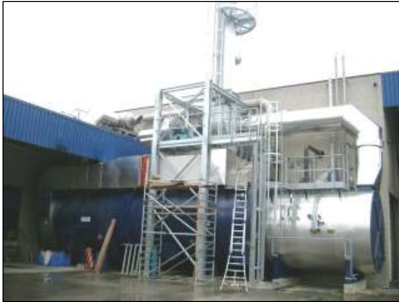
LedeNOx type incinerator met stoom-recuperatieketel en luchtvoorverwarmer.
