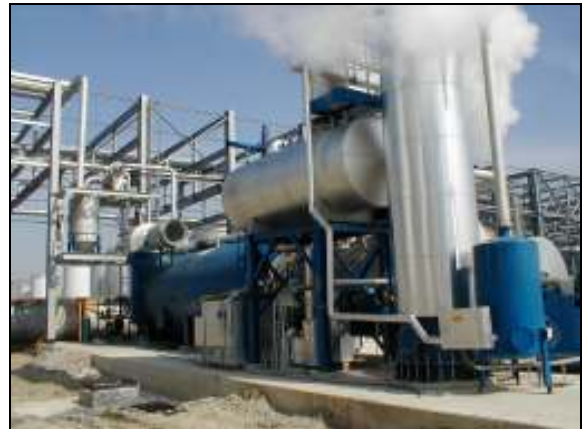
Stoom-recuperatieketel na verbrandingsoven.
