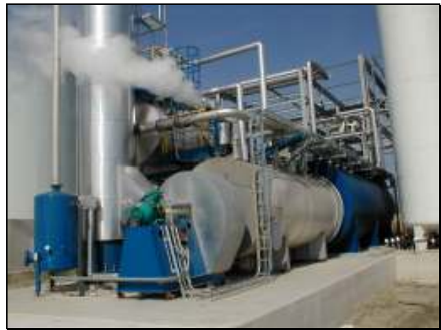
Zone 0 afgasincinerator met stoom-recuperatieketel.
