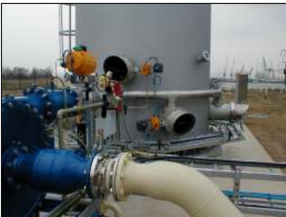
Zone 0 afzuiging : leidingwerk en kleppentrein.
