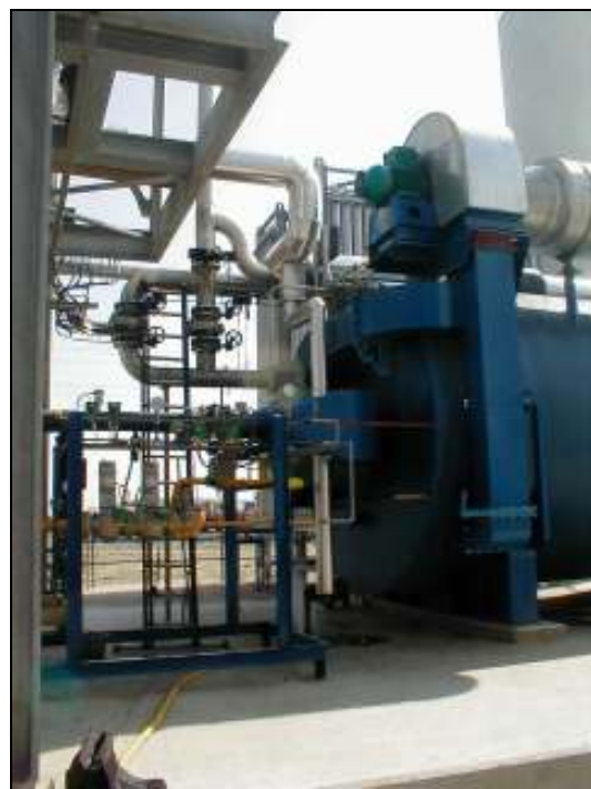
Zone 0 afzuiging tot aan inlaat verbrandingskamer.
