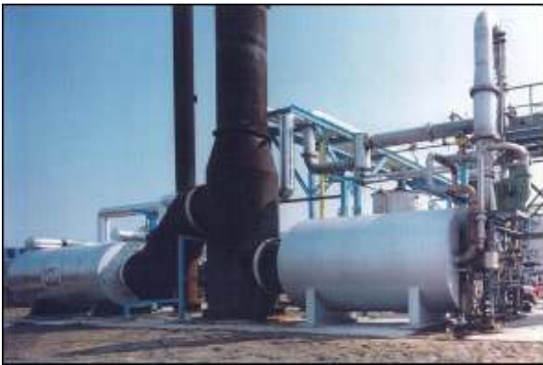
Gas/vloeistof incinerator met thermische olie-ketel.
